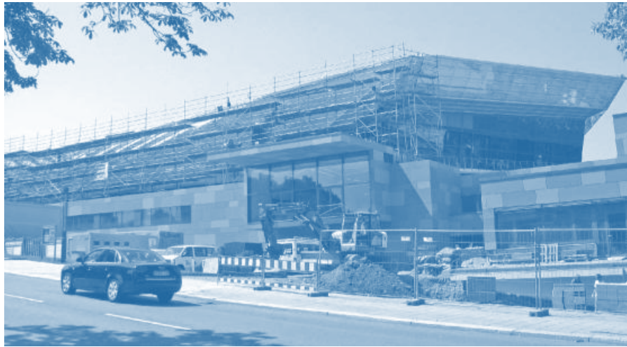
Die Freiheitshalle - Sanierung und Teilneubau erzeugen Misstöne durch höhere Kosten.
