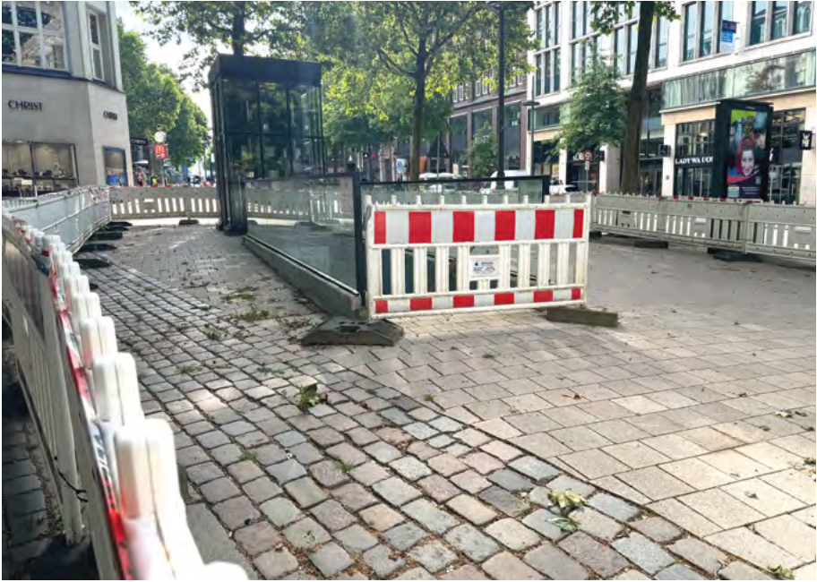
Die öffentliche Toilettenanlage am Rande der Hamburger Mönckebergstraße wurde ein Jahr lang für 2,08 Mio. Euro saniert. Und jetzt? Wieder ein Sanierungsfall!
